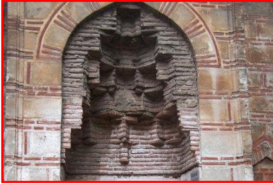
Resim 1.3: Yapı hasar tespiti fotoğrafı
